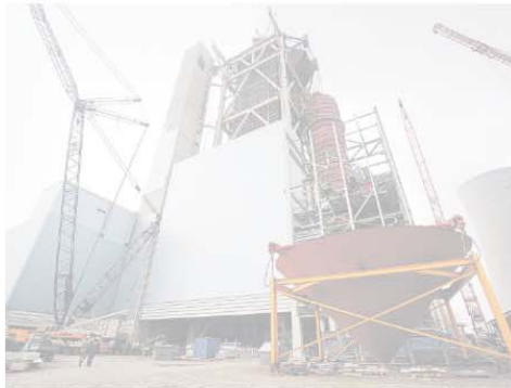
Gefährdeter Stahlriss: Im neuen Kesselhaus des Braunkohlekraftwerks Neurath-Grevenbroich brannte teilweise bereits das Feuer. Doch haben feine Risse in den Schweißnähten die Inbetriebnahme erst einmal gebremst.
